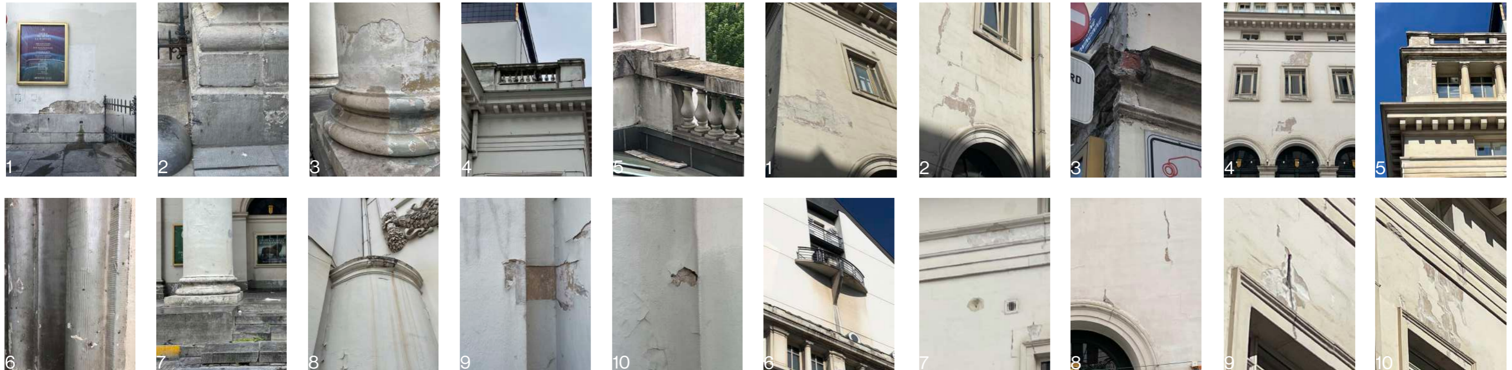
Afbeeldingen : waargenomen degradatiepatronen
