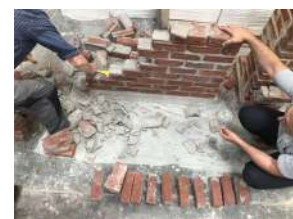
TESTEN VOOR RECUPERATIE VAN BAKSTENEN MET KALKCEMENTMORTEL (REF. MAKER) ESSAIS DE RÉCUPÉRATION DE BRIQUES AU MORTIER DE CHAUX ET DE CIMENT (REF. MAKER)
