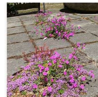
pavés joints ouverts
