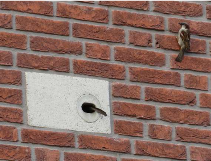
NESTKAST GEïNTEGREERD IN HET METSELWERK
