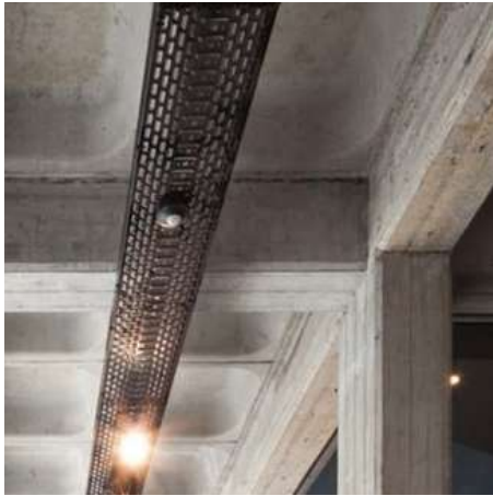
Des chemins de câbles, discrets mais accessibles dans l'espace, facilitent les adaptations.
